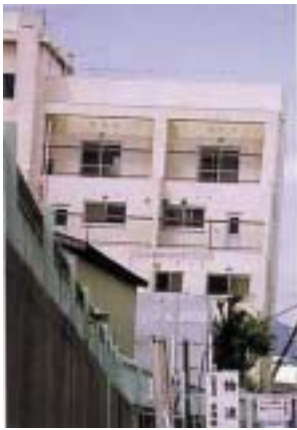
写真-3 傾いたマンション
