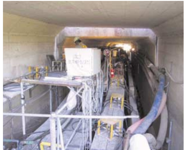
ボックス内に設置された集中制御装置
